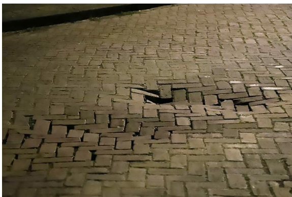
Foto 1: Voorbeeld van onderspoeld en verzakt straatwerk
